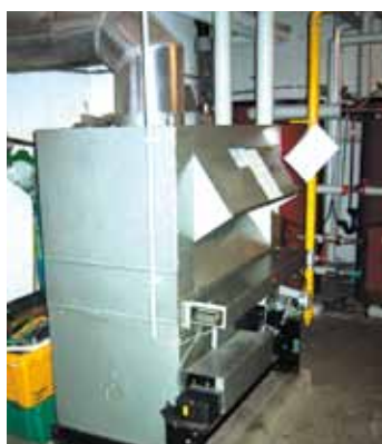
Chaudière à gaz
